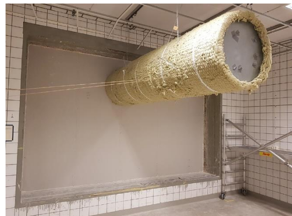
Genomföring av cirkulär kanal med dimension \varnothing 630 mm och svepning med 50 mm tjock stenull längs med hela kanalen på båda sidorna, densitet: 100 \text{ kg/m}^3 .
